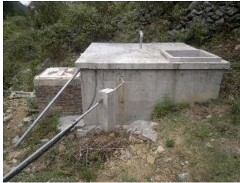
Fotografía 12. Caja de captación de agua
