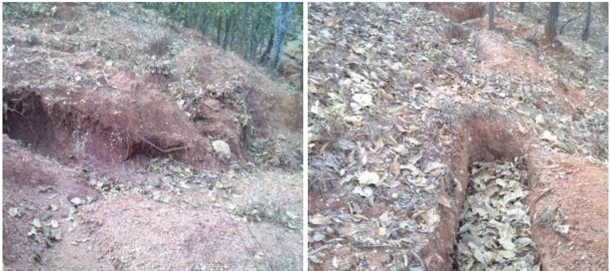
Fotografía 10. Zanjas trinchera socavadas
