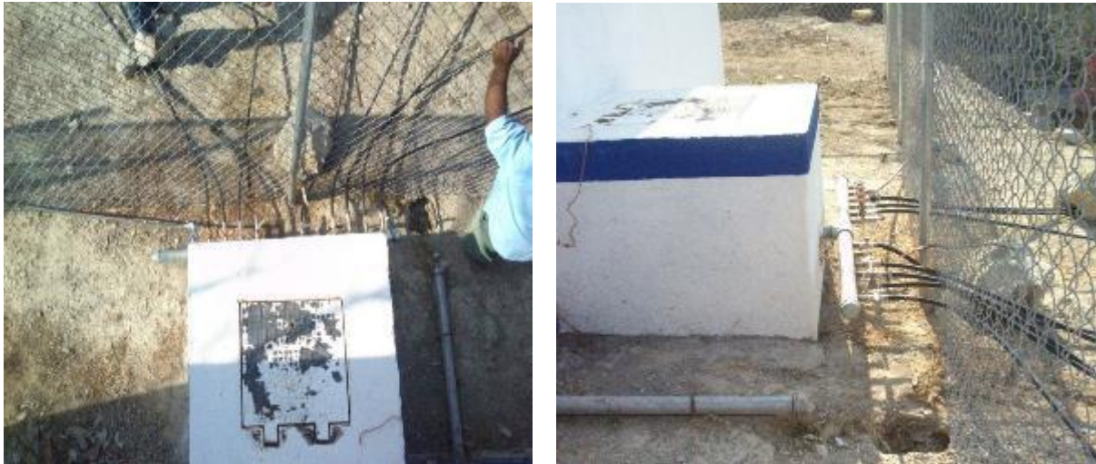
Fotografía 6. Tomas de agua de la caja de almacenamiento
