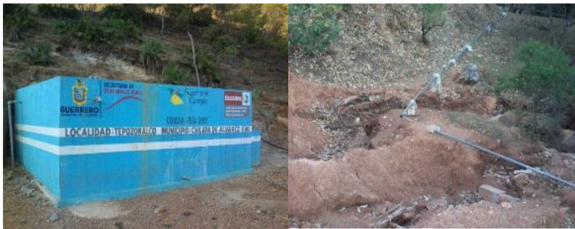
Fotografía 8. Tanque de almacenamiento y condiciones de la línea de conducción
