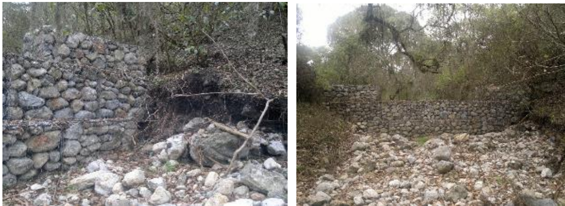
Fotografía 13. Condición actual de las presas de gaviones
