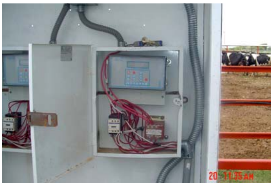
Cuarto de control
