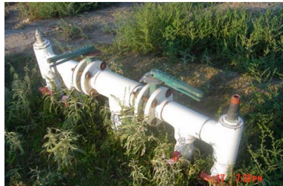
Válvula seccionadora de riego
