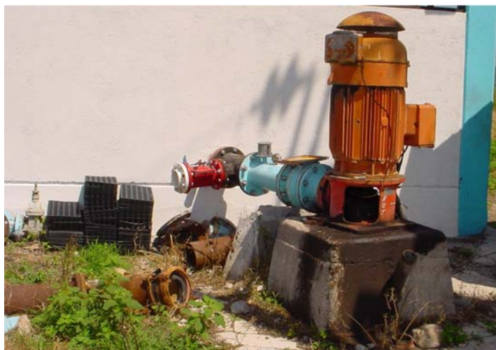
Figura 2. Pozo de extracción de agua subterránea.
