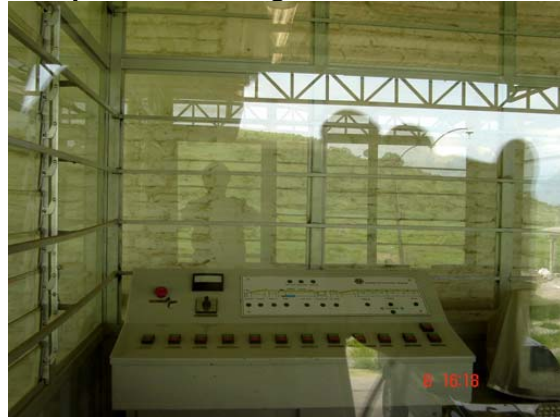
Módulo de control
