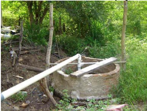
Sistema de bombeo del pozo
