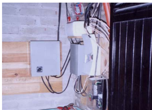
Control automático del sistema de riego
