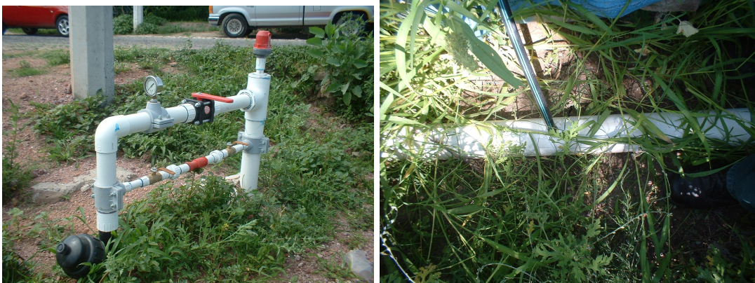
Figura 3. Sistema de riego por goteo ubicado en el pozo denominado la Palma de Gandho localizado en el municipio de Tecozautla, Hidalgo.
